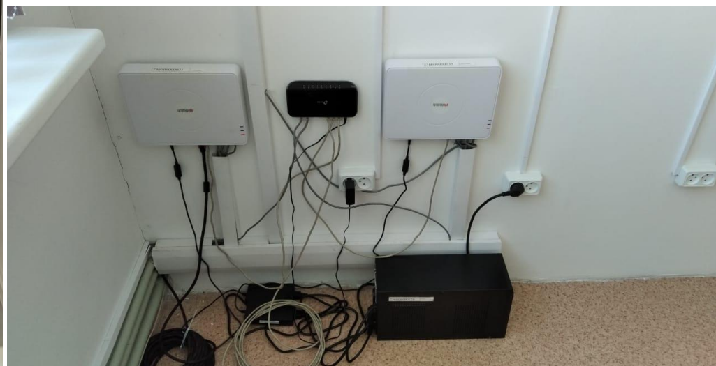
Серверное помещение № 2 с контрольным монитором видеонаблюдения
